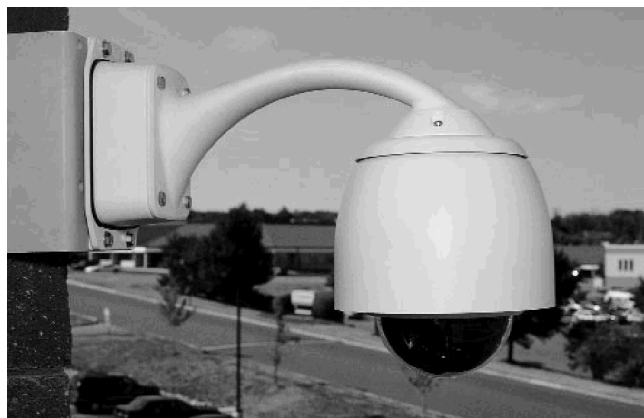
Rys. 1I. Zainstalowana kamera AutoDome
